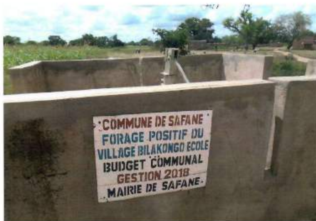
Forage dans le village de Bilakongo réalisé par la mairie de Safané
